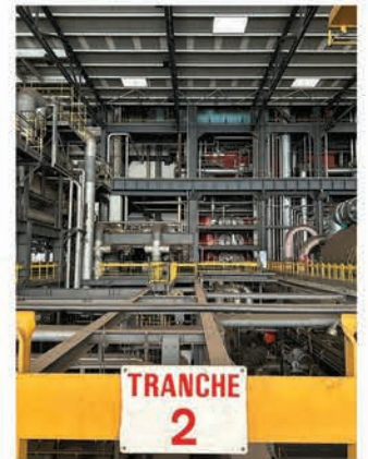
Intérieur de la centrale avec les anciennes installations
