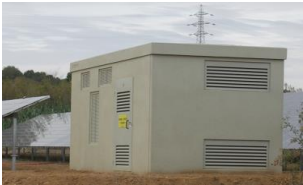
Poste de conversion : Onduleur et transformateur
