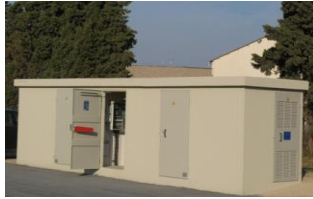
Poste de livraison : jonction avec le réseau
